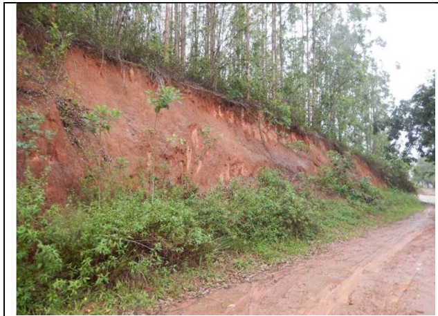
Talude de corte sem cobertura vegetal
