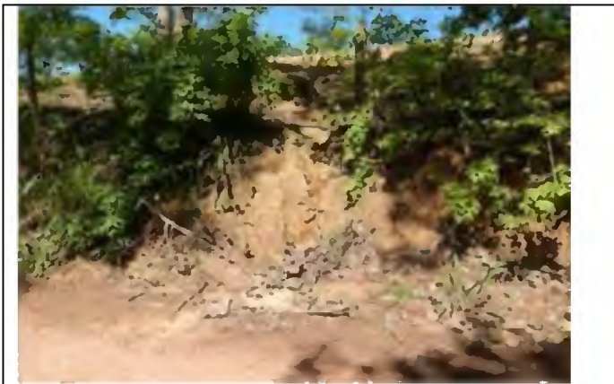
Talude de corte erodido
