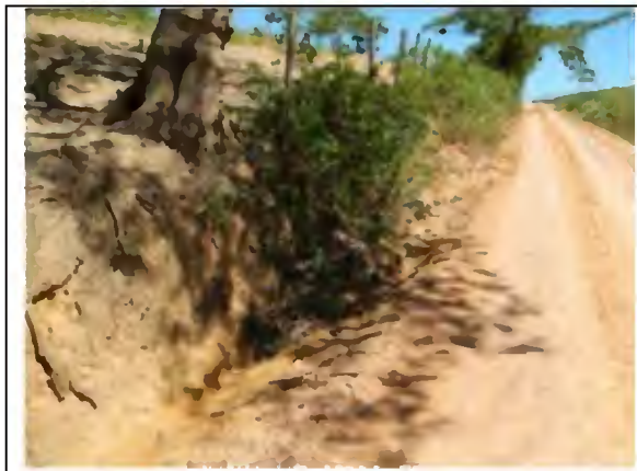
Assoreamento da rede de drenagem.
