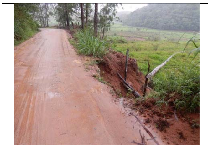
Erosão de média proporção no bordo da estrada existente.
