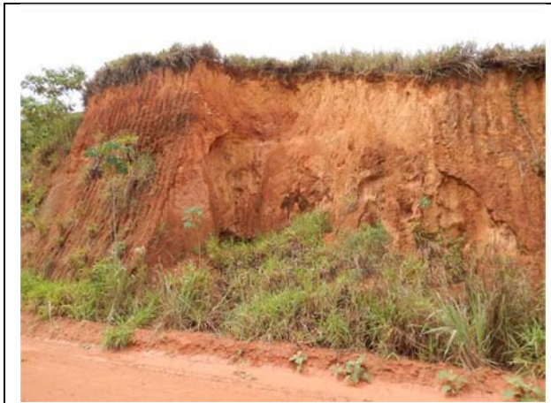
Talude de corte erodido.
