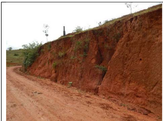
Talude sem cobertura vegetal.
