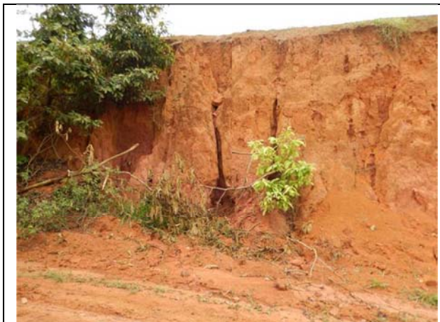
Talude de corte com pequenos sulcos erosivos.
