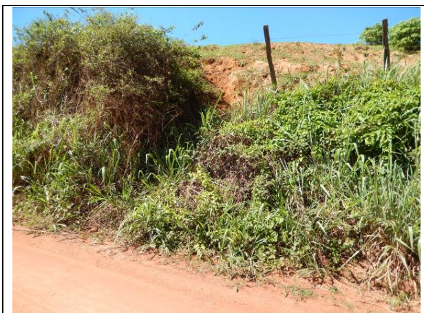
Erosão causada pela falta de drenagem.
