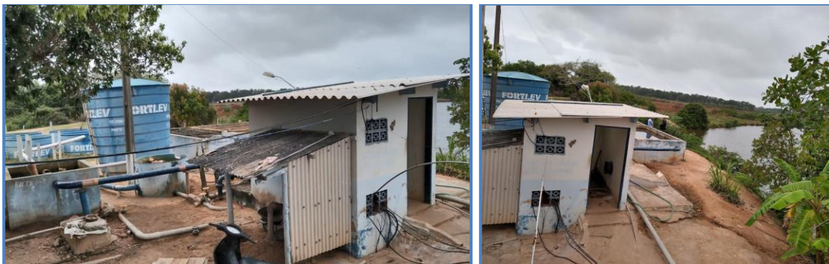
Foto 04 - Condições Físicas da ETA de Praia das Neves. Observar o processo erosivo que coloca em risco a ETA
