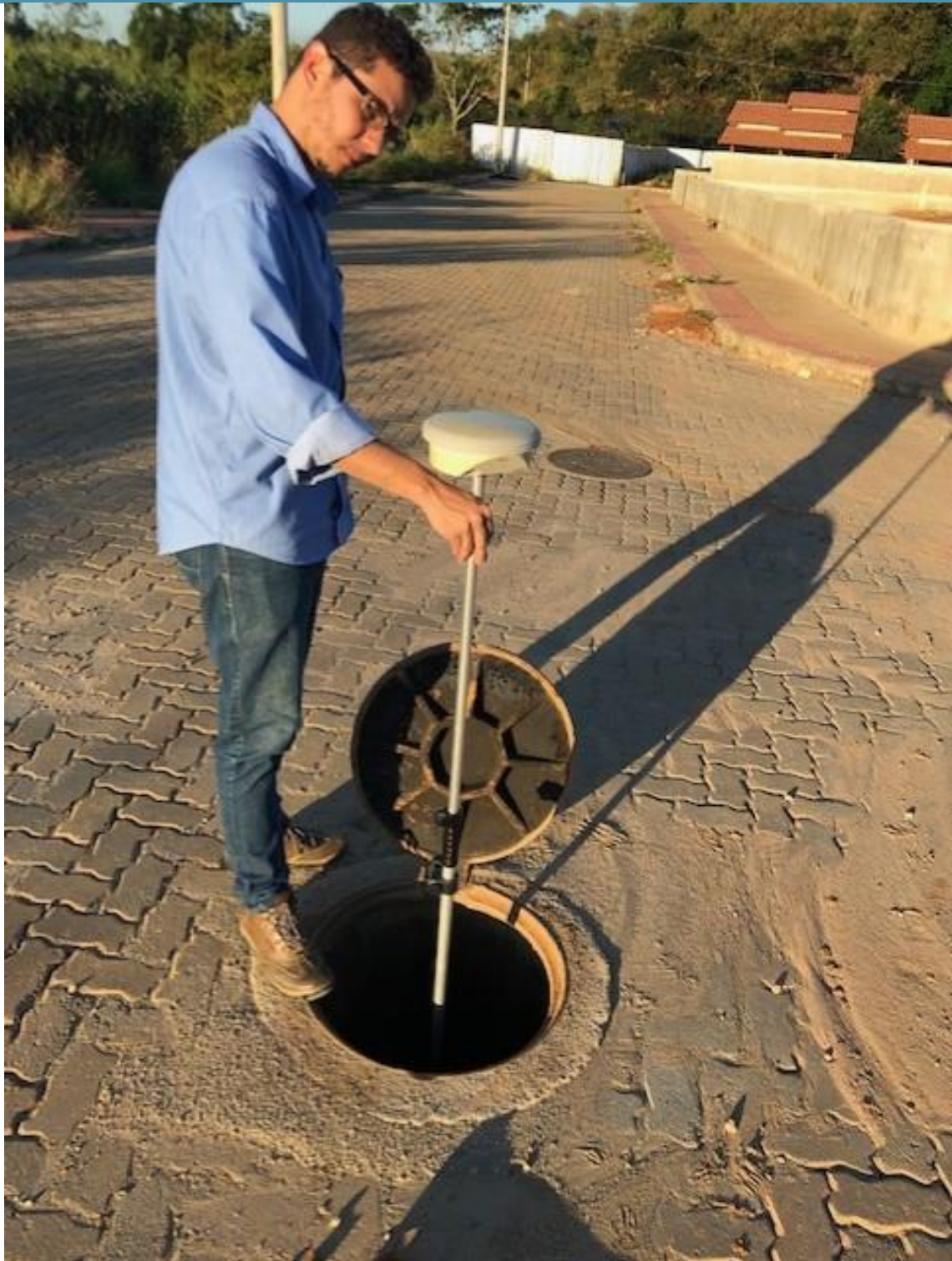
Foto 04 – Cadastramento dos itens da rede existente no condomínio de casas em São Paulinho
